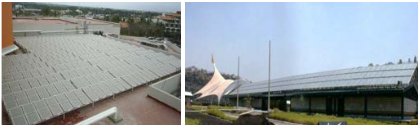
Fig. 3.6 Instalaciones de sistemas solares para sector servicios.
